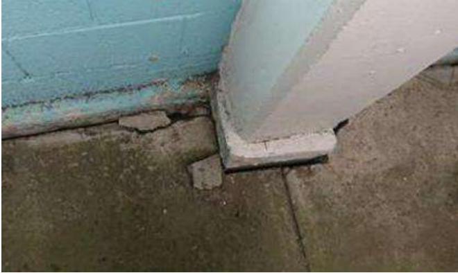
Daños por sismo, Preescolar Cuicacalli (Foto)
