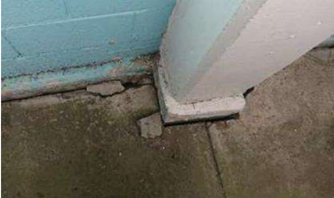
Daños por sismo, Preescolar Cuicacalli (Foto)
